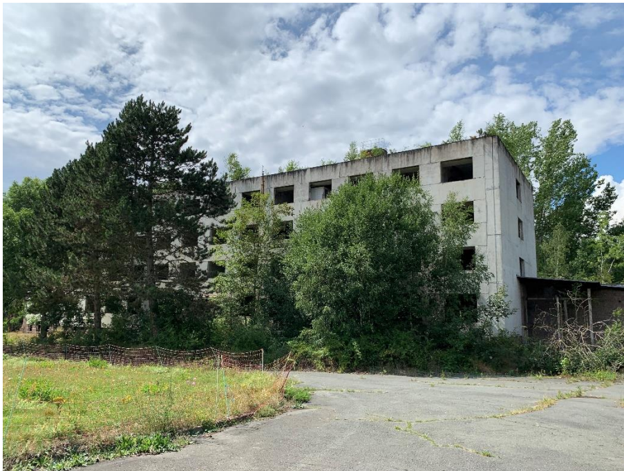
Abb.9: Viergeschossige, unterkellerte Bauruine im Geltungsbereich 2 des Bebauungsplanes
